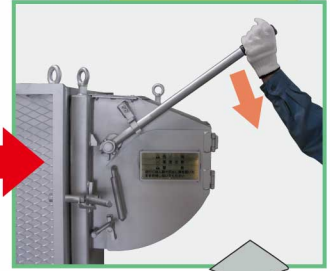
レバーを下げ 炉内に焼却物を投入する
